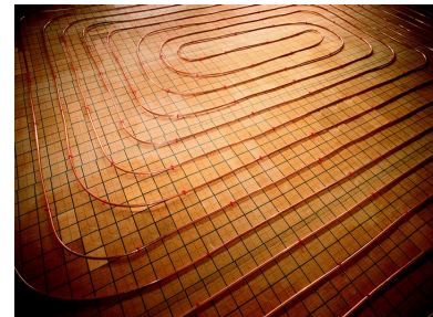
Sistema de calefacción con cobre
